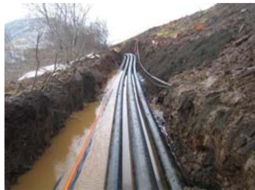
Lagnir við Urðarveg við Gleiðarhjalla, Ísafirði.
