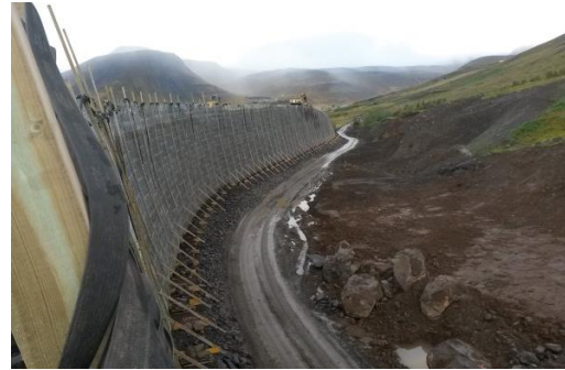
Lagnir við Urðarveg við Gleiðarhjalla, Ísafirði.
