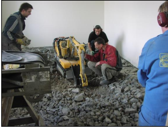
Gólf á 1. hæð brotin upp vegna rakaskemmda.
