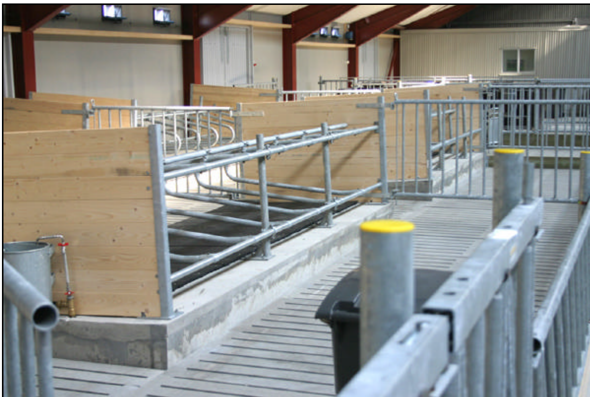
Básgrindur og fleira í vel þúnu Hvanneyrarfjósinu. Ljós. Rafteikning hf.
