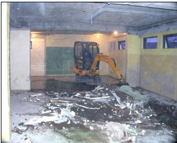
Brjóta varð upp meginhluta efri gólfplötunnar
