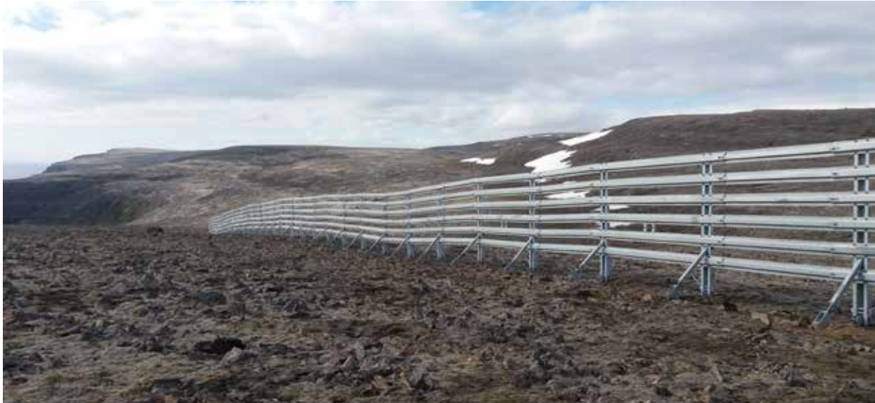
Mynd 2. Uppsettar snjósöfnunargrindur.
