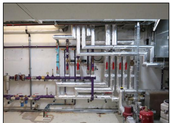
Lagnagrind í tæknirými.
